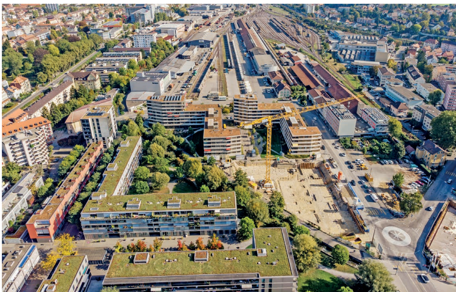
Wo der Kran steht, wird die letzte Wohnüberbauung auf dem Drahtwerkareal erstellt.
